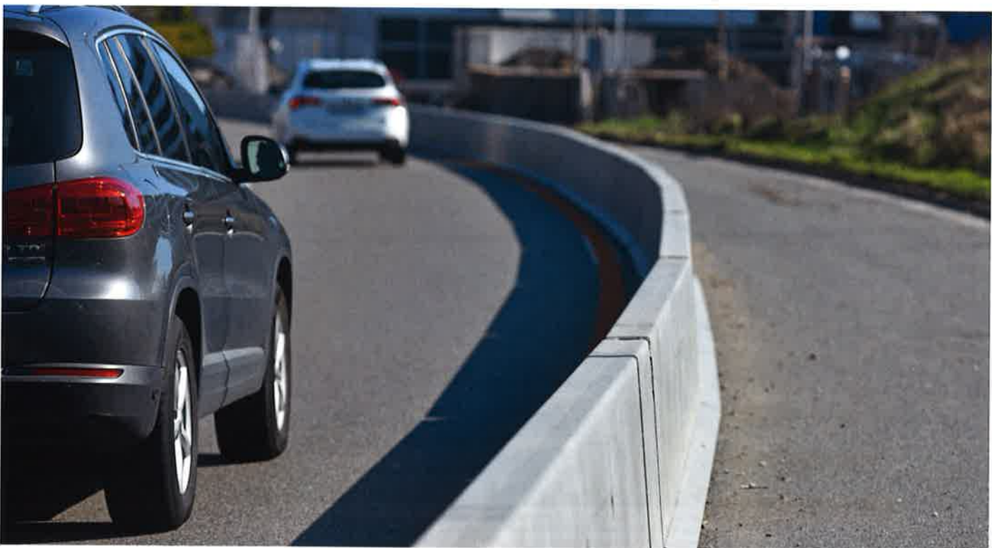
Diese Rückhaltesystemlösung aus Betonfertigteilen sorgt für hohe Verkehrssicherheit – zum Beispiel beim Projekt Einhausung Schwamendingen.
